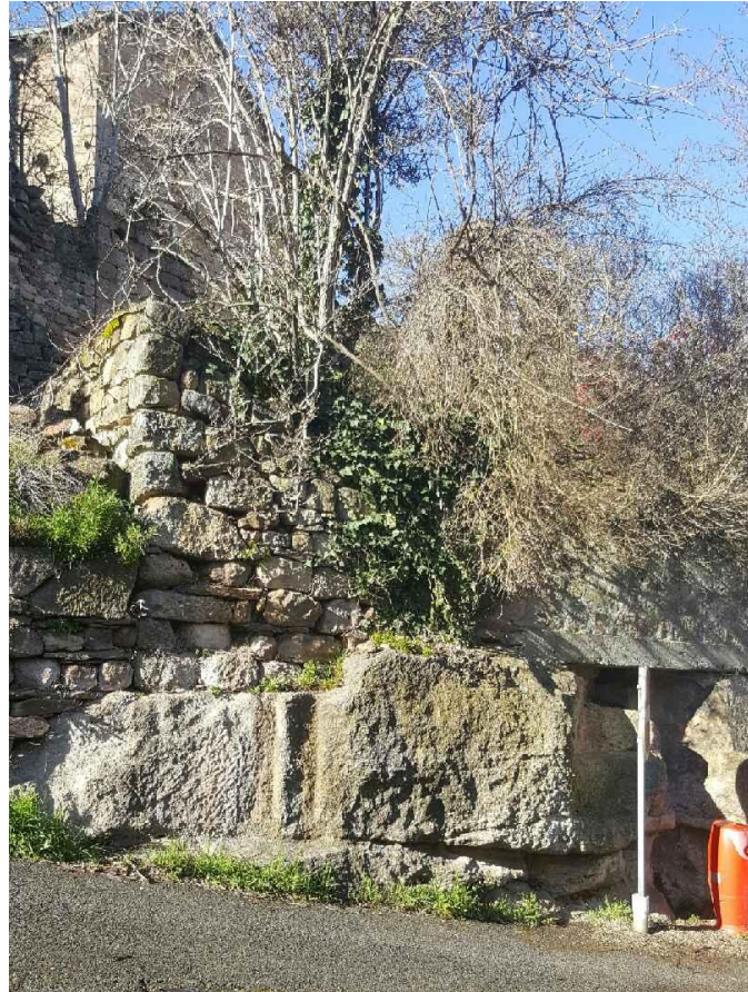
Fig.17 Emplacement de la porte fortifiée de Sainte-Catherine qui faisait communiquer le bourg fortifié de Montjoux avec le faubourg de l'église et le chemin vers Roquetaillade. On distingue encore le départ du montant gauche de la porte taillé dans le rocher (photo Alain Bernat, 2008).
